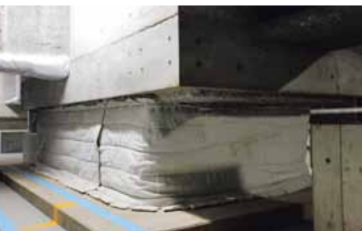
1本あたり6,000tの重力に耐えられる、日本最大級の免震装置。 免震層はフェスティバルホールと中間層オフィスの間に。
